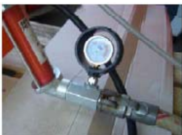
Рис. 22: Манометр давления раствора
