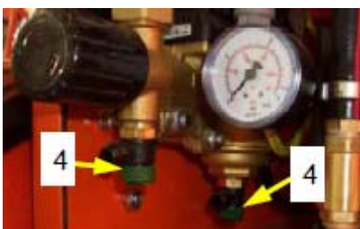
Рис. 69: Открытие сливного крана
